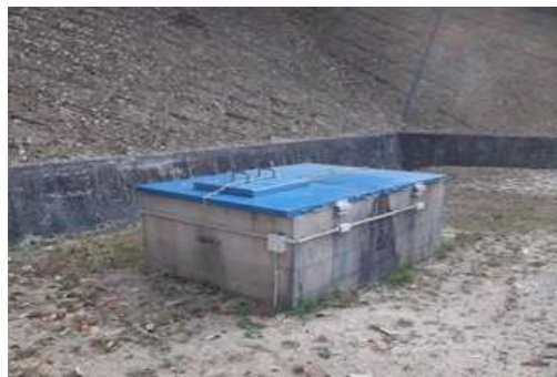
《水源取水ポンプ》
