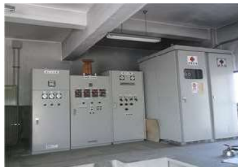
《受電設備、計装盤、ポンプ盤》
